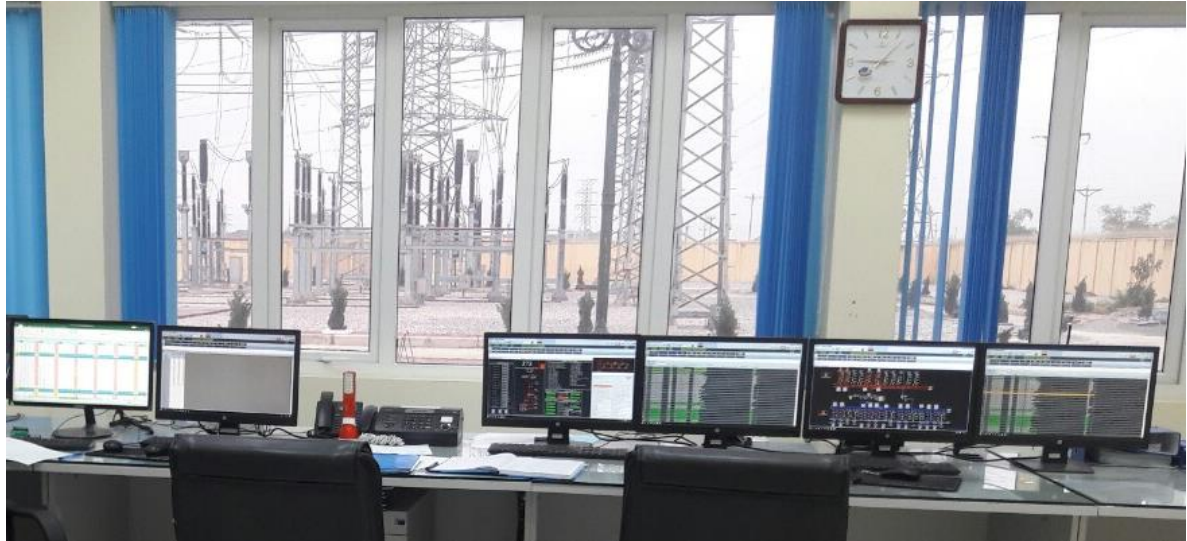
Hình 2.14. Hệ thống GSC1000C TBA 220kV Thanh Nghi
