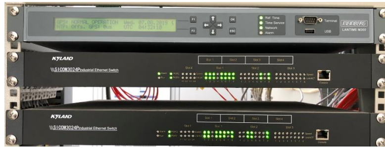
Hình 2.18 Khởi động ESW, GPS tại tủ Server
